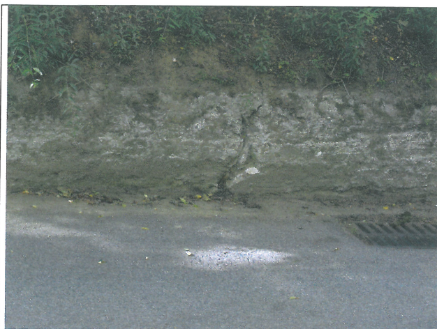
Uszkodzenia muru oporowego w południowej części osuwiska przy ulicy nadole
