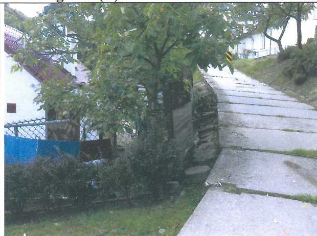
Północna część osuwiska, ulica Skrajna biegnąca przez strefę skarpy głównej osuwiska
