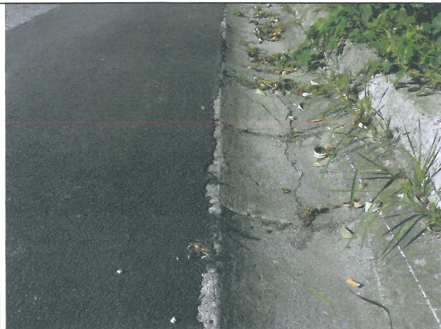
Uszkodzone korytka betonowe wzdłuż ulicy Skrajnej
