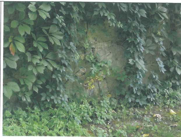
Uszkodzenia i przemieszczenia muru oporowego w centralnej części osuwiska
