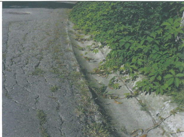
Uszkodzenia i pochylenie drogi (ulica Skrajna)
