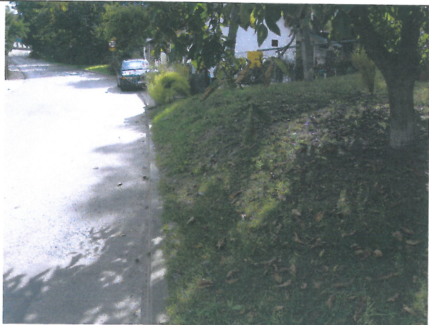
Czoło koluwiów w północnej części osuwiska przy krawędzi ulicy Nadole.
