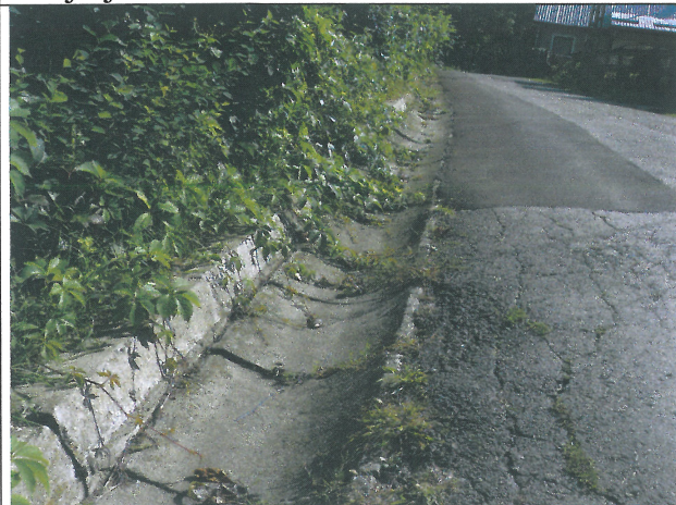
Uszkodzenia asfaltu, naruszone korytka betonowe (ul. Skrajna)
