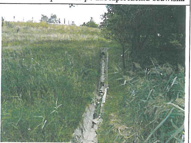
Drenaż w południowej części osuwiska.
